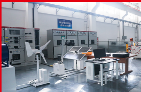
新型电力系统实训基地
