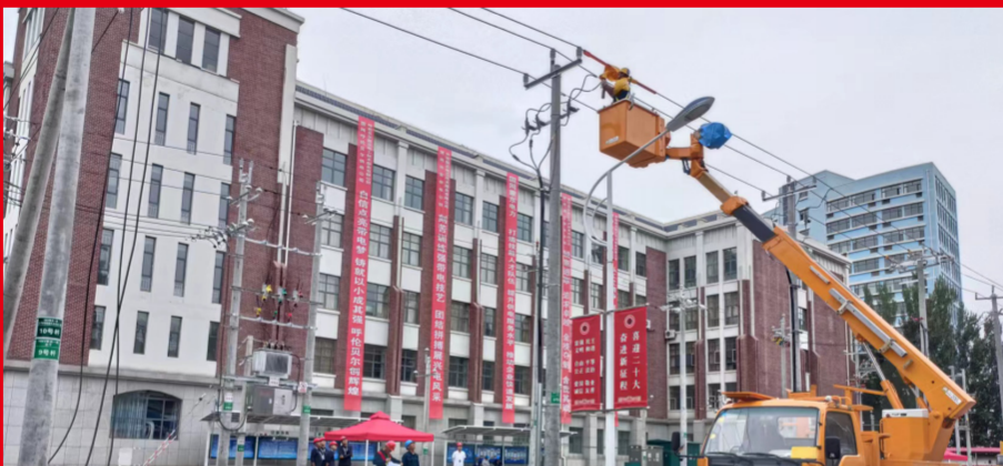
供用电技术校内实训基地
